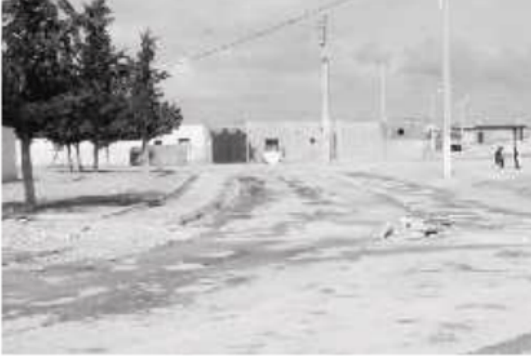
هكذا هو حال طرقات بلدية البويهي
