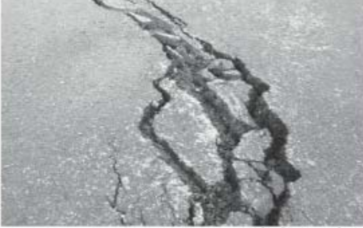
حفر وأخاديد عميقة تقلا الشارع
